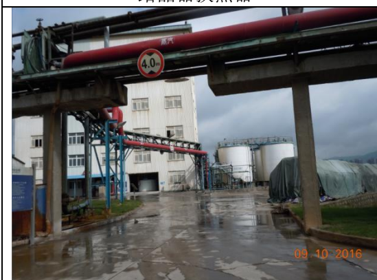
物料输送管线
