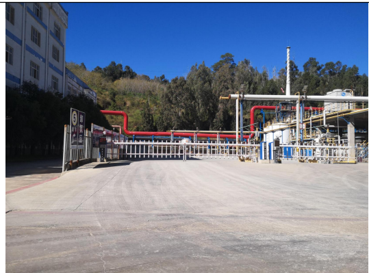
新增蒸汽管道（红色管道，并入全厂蒸汽管网）
