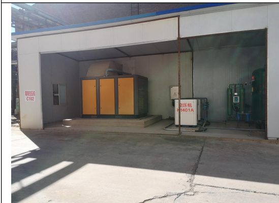
新增空压机（白色设备）
